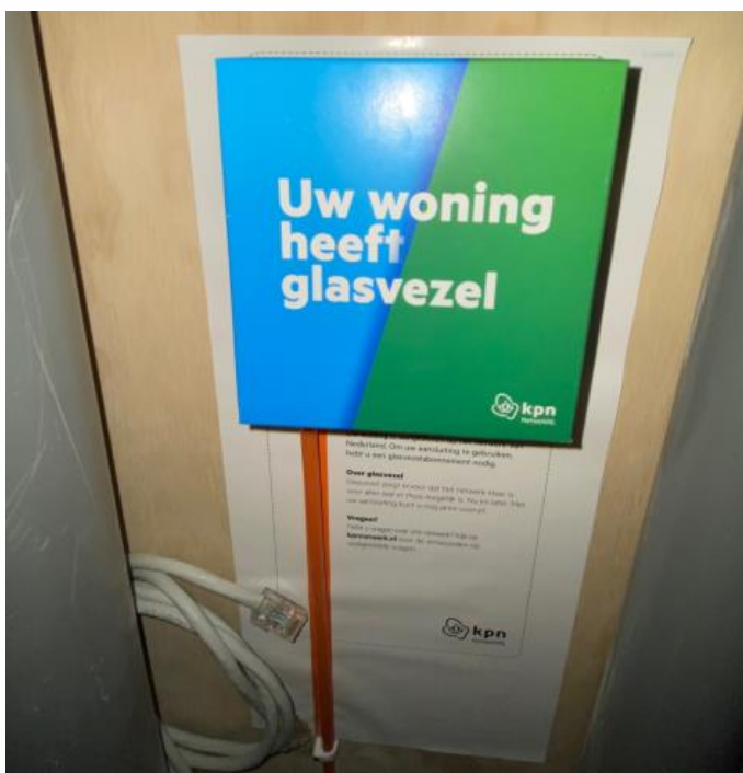
In de meterkast zit de aansluiting voor glasvezel
