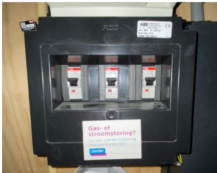
In de meterkast bevinden zich de hoofdschakelaars.
