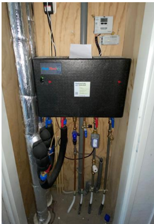
In de meterkast bevindt zich de stadsverwarmings-unit
