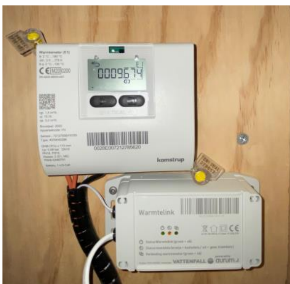
In de meterkast hangt boven de stadsverwarmings-unit de GJ-meter.
