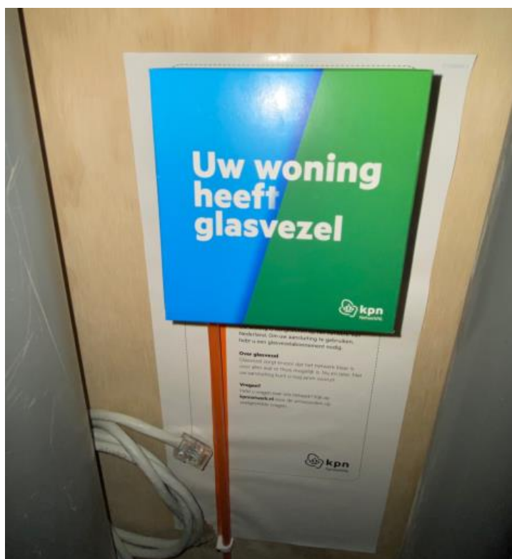
In de meterkast zit de aansluiting voor glasvezel
