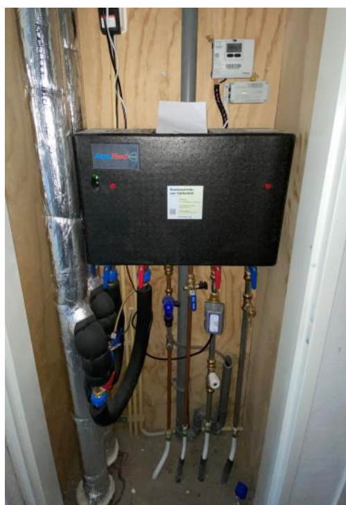
In de meterkast bevindt zich de stadsverwarmings-unit.
