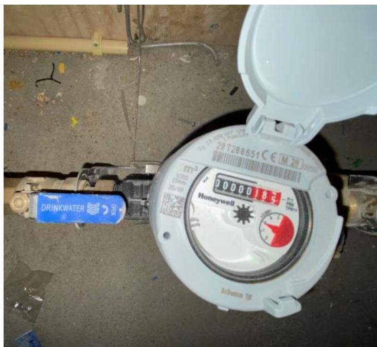
In de meterkast zit de watermeter en de hoofdkraan. Indien de blauwe hendels haaks op de leiding staan dan is de waterleiding afgesloten.
