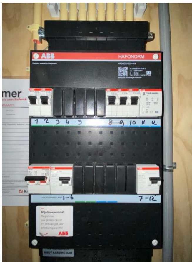
In de meterkast hangt de groepenkast met links daarnaast informatie over de indeling
