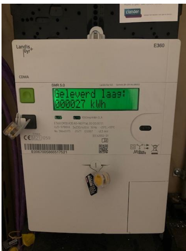
In de meterkast hangt de elektrameter. Door op de groene knop naast het schermje te drukken kunt u uw meterstanden aflezen.
