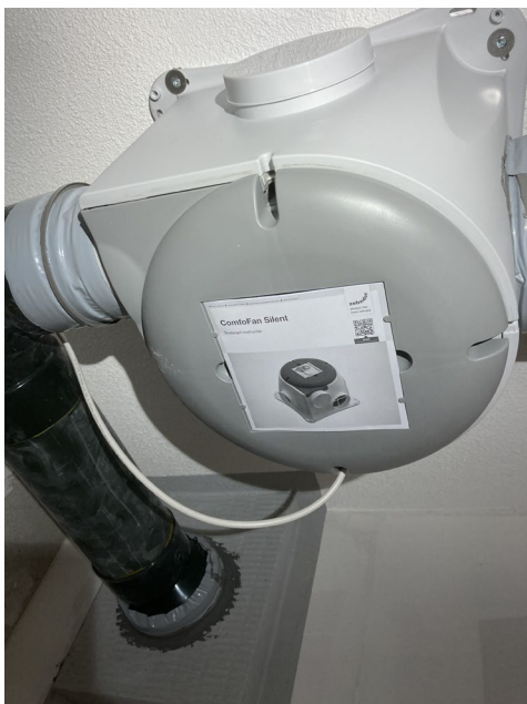
mechanische ventilatiebox tegen plafond berging
