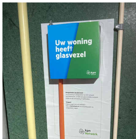
In de meterkast zit de aansluiting voor glasvezel
