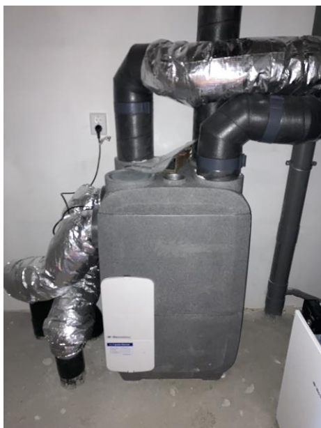
De ventilatie-unit/ WTW-box
