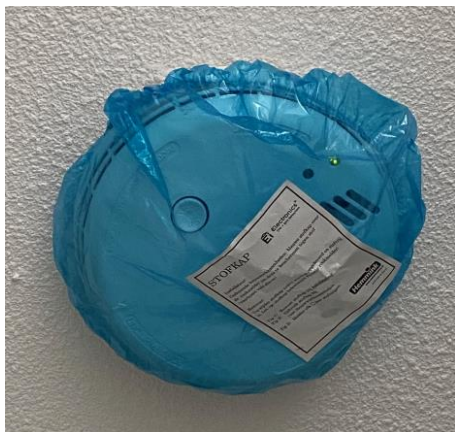
De rookmelder hangt in de gang. Bij de oplevering zit er nog een stofkap overheen.
