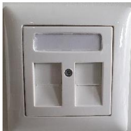
In de woonkamer zitten verschillende bedrade data-punten voor bijvoorbeeld de tv-aansluiting
