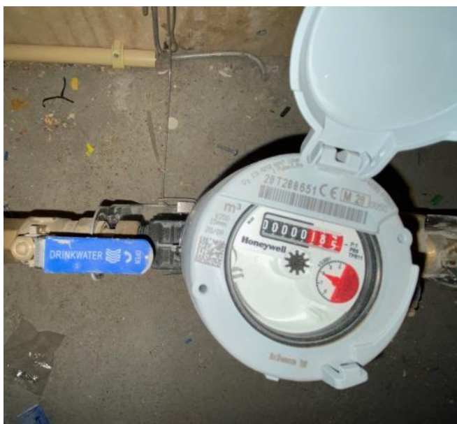
In de meterkast zit de watermeter en de hoofdkraan. Staan de blauwe hendels haaks op de leiding? Dan is de waterleiding afgesloten.
