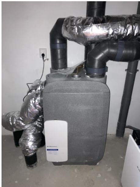
De ventilatie-unit/ WTW-box
