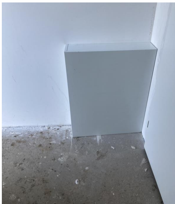
De verdelers van de vloerverwarming zijn met een koof afgeschermd
